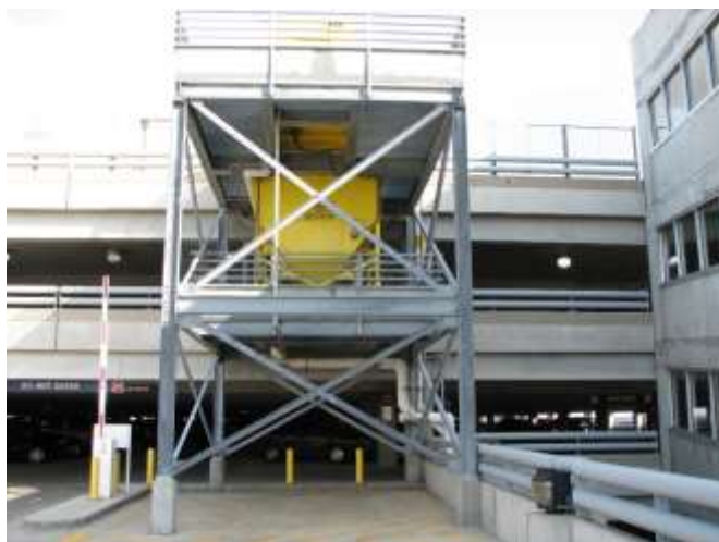
Стационарные снеготаялки Trecan 20-SG производительностью 20 тонн снега в час, Миннеаполис, США, паркинг аэропорта
