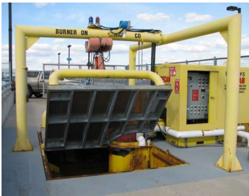
Стационарная снеготаялка Trecan 20-SG производительностью 20 тонн снега в час, Миннеаполис, США, паркинг аэропорта
